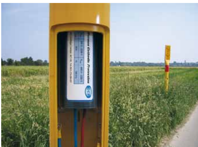
AC-Abgrenzeinheit VL-14-401, eingebaut in einer Schilderpfahl-Meßstelle
