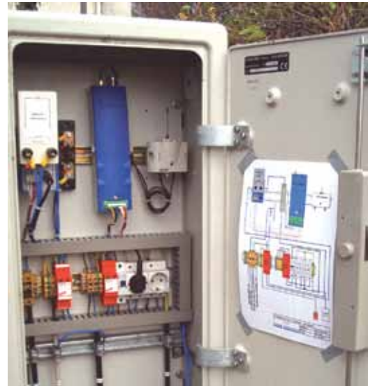
Ferngesteuerte Schutzanlagentaktung mit Netzteil innerhalb des Schutzstromgerätes
