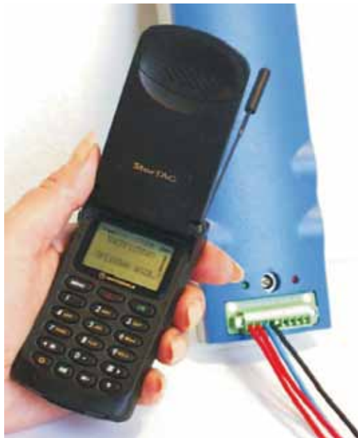
Schutzanlagensteuerung per Handy
