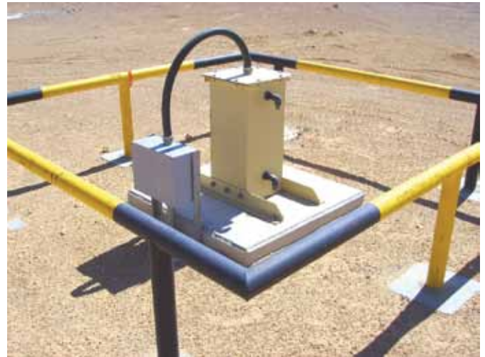
Anodenverteilerkasten mit Stahlbefestigungsstruktur an einer Tiefenanodenanlage
